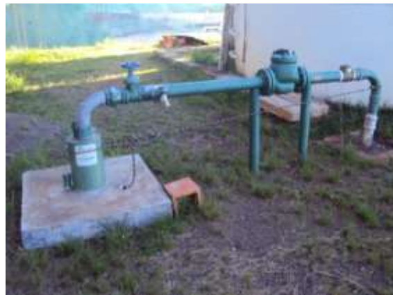
Figura 34 – Poço CPFL. Fonte: LPL Engenharia,2012.
