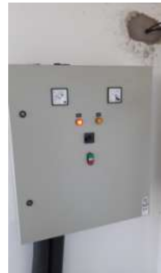
Figura 55 – Painel de Comando.
