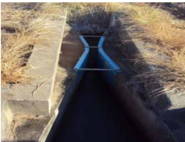
Figura 69 – Medidor de vazão tipo calha Parshall.
