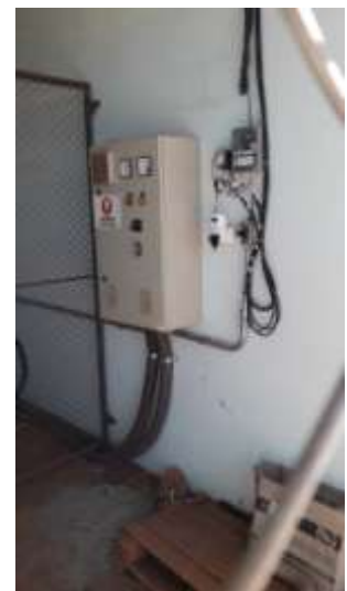
Figura 51 – Painel de Comando.
