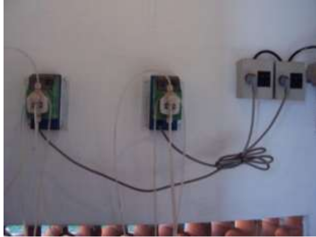
Figura 32 – Dosador de cloro e flúor do reserv. CDHU. Fonte: LPL Engenharia,2012.
