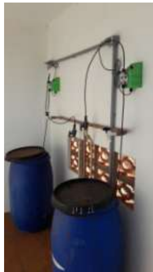
Figura 58 – Dosadores de Cl - e F - do Reservatório Julieta.
