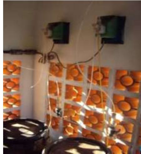
Figura 36 – Dosadores de Cl - e F - do reserv. Nosso do reservatório Nosso Teto.
