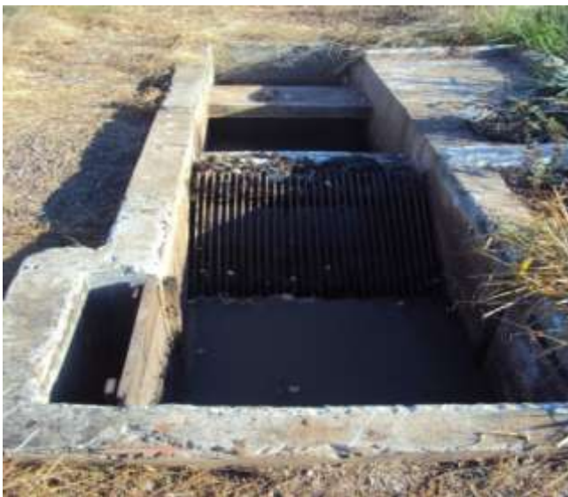
Figura 68 – Sistema de Gradeamento. Fonte: LPL Engenharia, 2012
