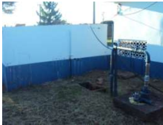
Figura 45 – Poço São Berto I e ao fundo o reservatório Cemitério. Fonte: LPL Engenharia, 2012.
