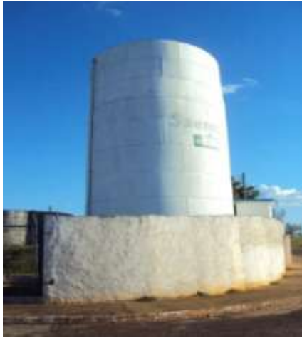
Figura 31 – Reservatório CDHU. Fonte: LPL Engenharia,2012
