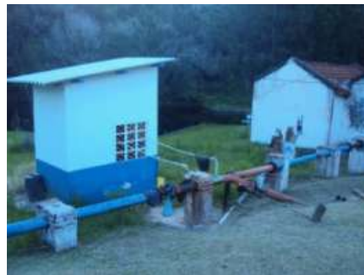
Figura 38 – Casa dosadora do poço DAEE e SAEMAN.
