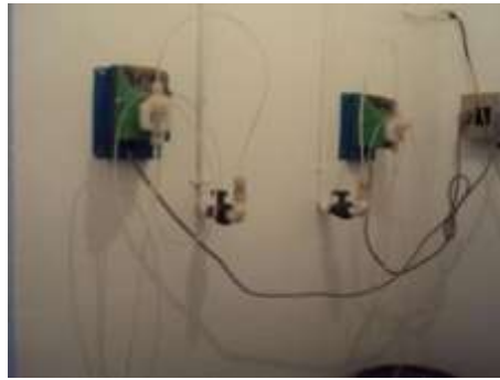
Figura 48 – Dosadores de Cl^- e F^- do Reservatório São Berto. Fonte: LPL Engenharia, 2012.
