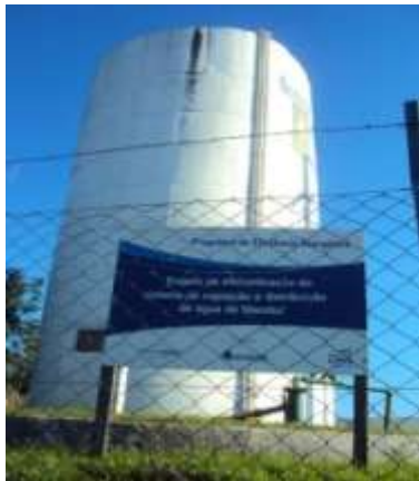
Figura 33 – Reservatório Nosso Teto. Fonte: LPL Engenharia ,20123.
