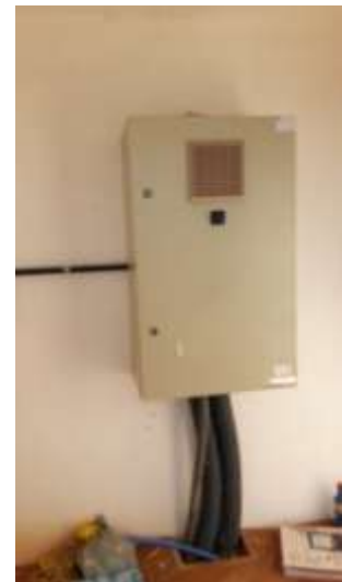
Figura 59 – Painel de Comando.
