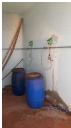
Figura 50 – Dosadores de Cl^- e F^- do Reservatório Julieta
