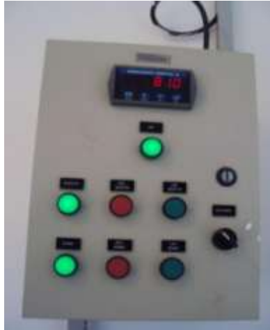
Figura 35 – Painel do controle via rádio Teto.
